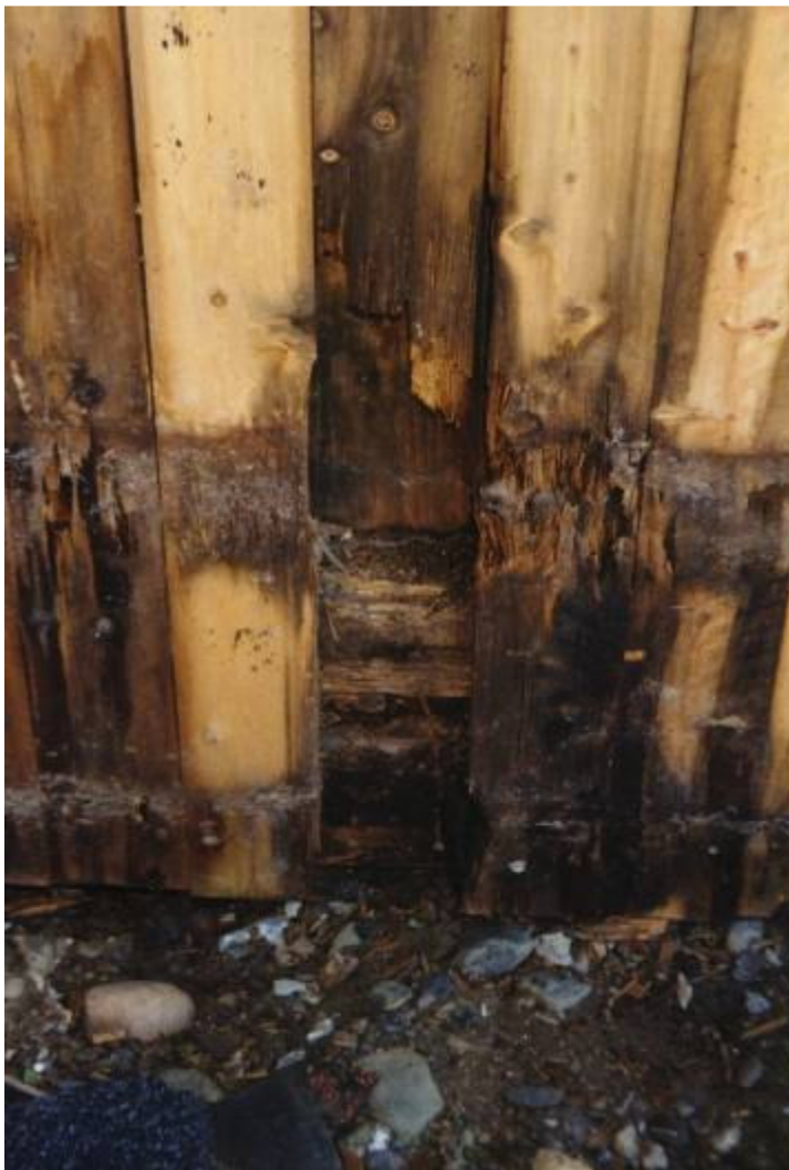
Her skal råddensskaben fjernes og nye brædder sættes ind.
