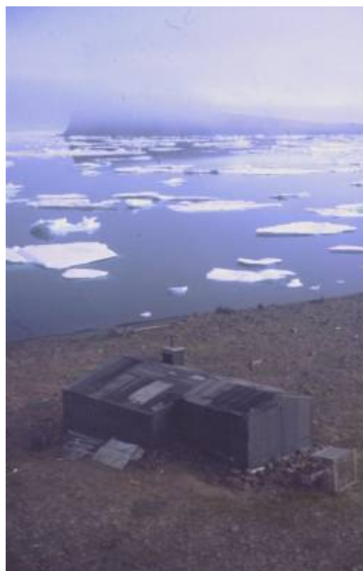
Helikopterrekognosceringen til Germaniahavn viste, at der var store, åbne huller i taget. Indenfor drev fugten nedad væggene.
