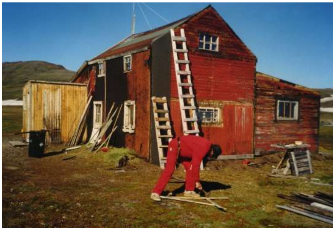
Sådan så Myggbukta ud kort efter ankomsten. Arbejdet er begyndt. Pappen er fjernet fra vindfanget. Den første bane tagpap er sømmet på sydgavlen. Tagvinklen måles op.
