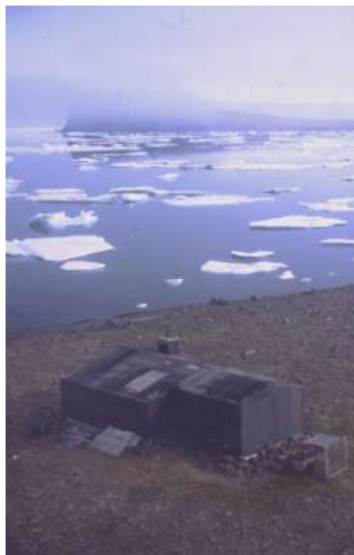
Helikopterrekognoseringen til Germaniahavn viste, at der var store, åbne huller i taget. Indenfor drev fugten nedad væggene.
