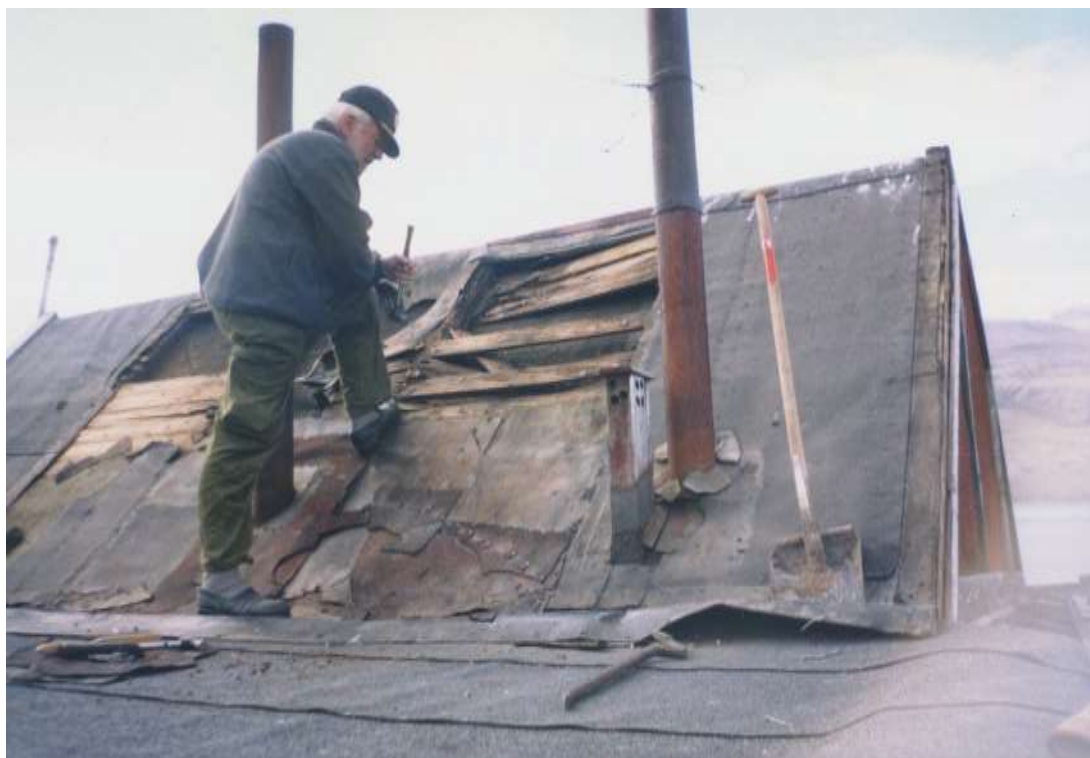
Jannik på taget af Hoelsbu. Specielt taget på nordsiden trængte voldsomt til reparation.
